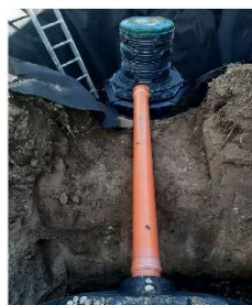
Túlfolyó 600L szikkasztó kútba vezetve
